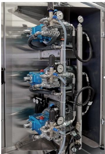
Układ pompy wysokociśnieniowej
