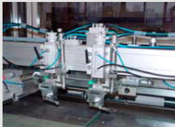
Il. 20: Zabezpieczenie przed skapywaniem z siłownikami.
